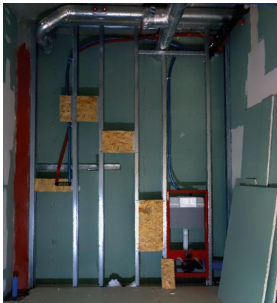
Rys. 9. Inwentaryzacja robót zakrywanych wewnątrz ściany działowej gipsowo-kartonowej (opracowanie własne)
