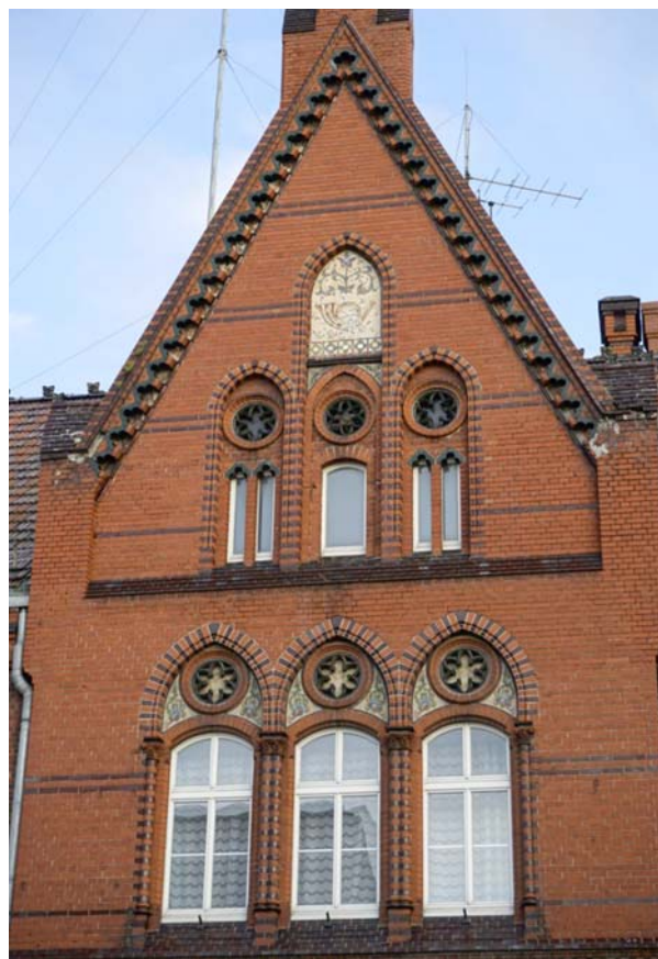
Ryc. 3. Fragment elewacji budynku poczty w Walczu z przełomu XIX i XX w. [16]
