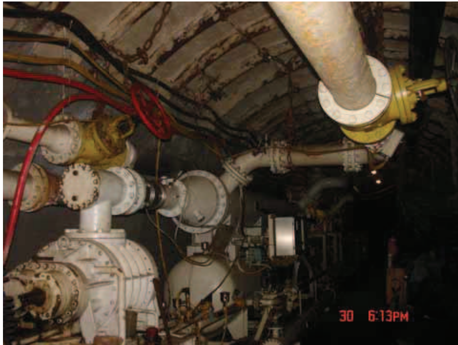
Rys. 1. Urządzenie GMC 1000 w komorze urządzeń chłodniczych na poziomie 900 m w KWK „Murcki-Staszic” [1]
