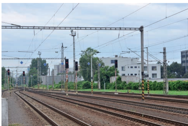
Rys. 6. Dwunapięciowa stacja Bratislava Petržalka (25 kV 50 Hz, 15 kV 16,7 Hz) (22.06.2019 r.) [fot. M. Graff]
