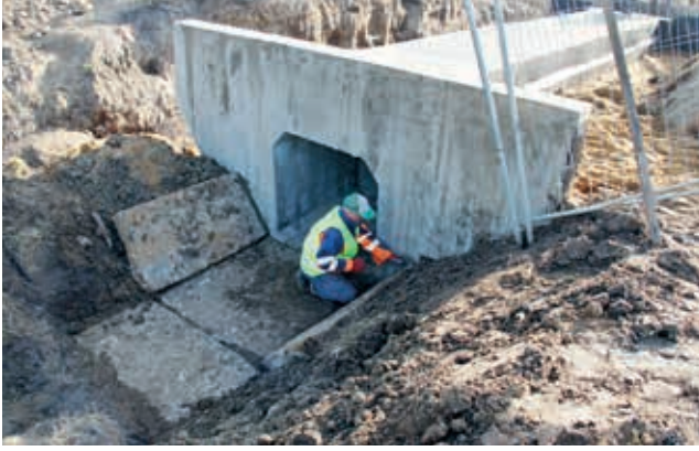
Ryc. 12. Przykład umocnienia wlotu przepustu z wykorzystaniem płyt kamiennych pochodzących z rozbiórki, fot. A. Wysokowski
