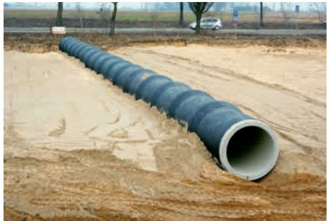
Ryc. 10. Widok wykonywania wstępnego etapu zasypki dla przepustu prefabrykowanego o przekroju kołowym, fot. A. Wysokowski
