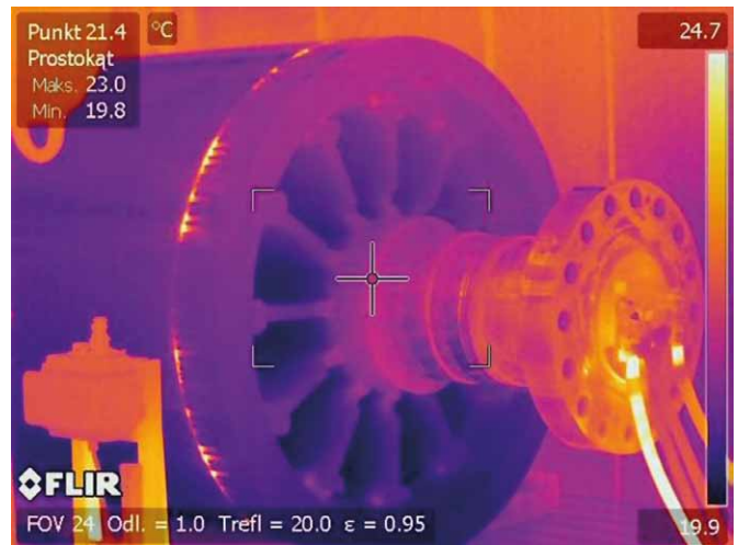
Rys. 30. Termogram przedstawiający nagrzane fragmenty klatki, wału i połączenia przewodów zasilających z wałem
