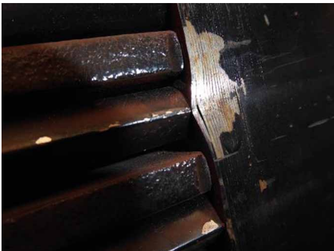
Rys. 28. Widoczne uszkodzenia pakietu przy prętach i klinach - miejsce nr 2
