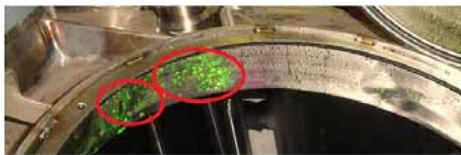
Rys. 5. Wybrany punkt kontrolny ZB m-2 – Właz inspekcyjny – Niepełne wypłukanie spowodowane cieniami rozpryskowymi [fotografia własna].
