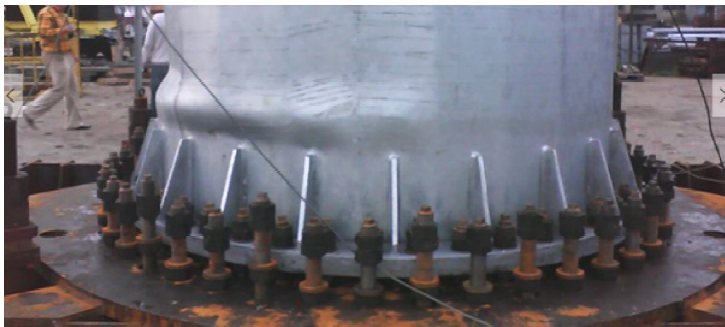
Rys. 6. Fotografia miejsca wyczerpania nośności słupa (fotografia autora)
