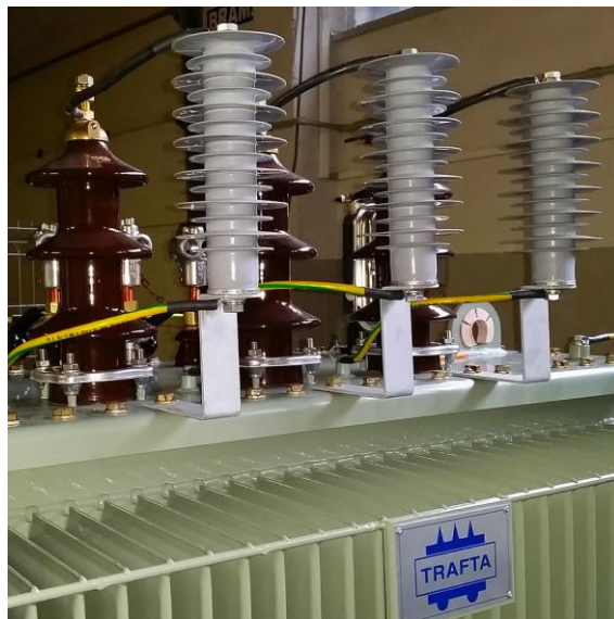
Fot. 4. Ograniczniki przepięć zainstalowane na dławiku kompensacyjnym średniego napięcia
