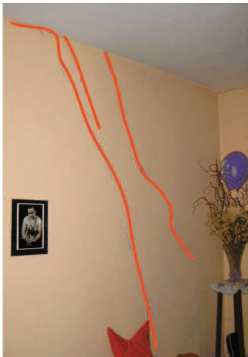
Rys. 7. Uszkodzenia zewnętrznej ściany wschodniej budynku w obrębie styku części budynku o różnej wysokości Źródło: Opracowanie własne
