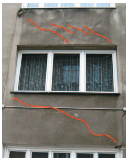
Rys. 4. Uszkodzenia zewnętrznej ściany zachodniej budynku w obrębie ścianek nad i podokiennych
