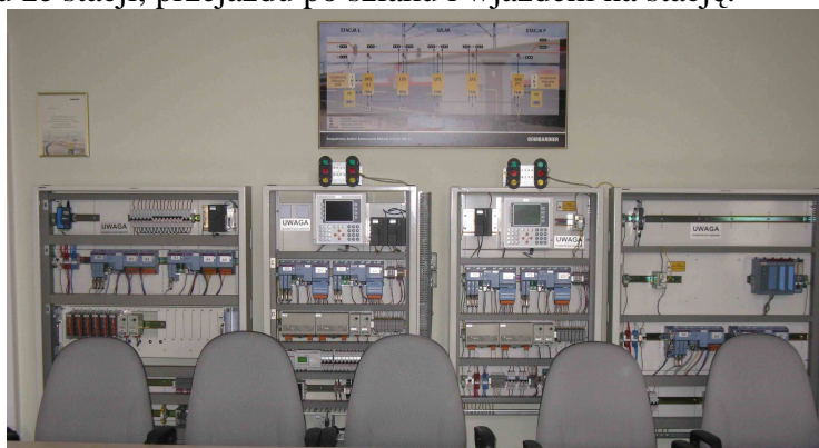
Fot. 1. Liniowe i stacyjne punkty sterowania komputerowej blokady liniowej SHL-12 z powtarzaczami semaforów odstępowych oraz panelami diagnostycznymi EZG-2101
