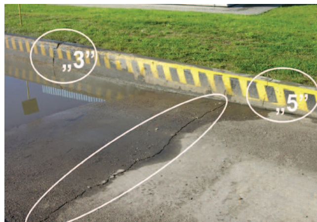
Rys. 8. Pęknięcia ściany i płyty dennej brodzika po stronie północnej
