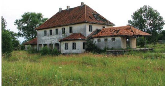
Fot. 11. Wybudowany w latach 30. XX wieku budynek dworcowy w Gołębicach jest sukcesywnie ograbiany przez okolicznych mieszkańców i grozi zawaleniem (22.07.2009 r.). Fot. T. Korycki
