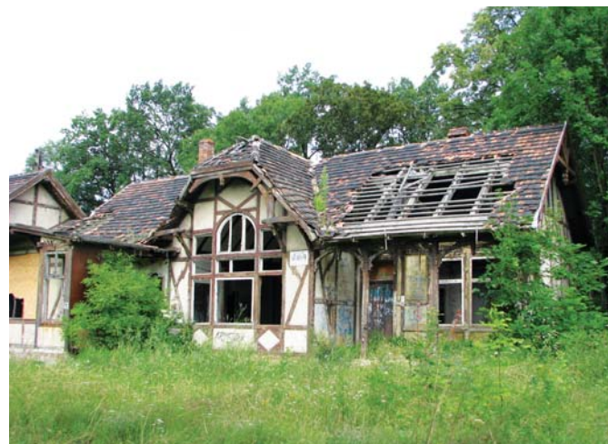
Fot. 8. Jedyne zachowane w oryginalnym kształcie budynki dworcowe w Marcinowicach Świdnickich, charakterystyczne dla małych stacji na odcinku Sobótka-Świdnica, jest obecnie całkowicie zrujnowany i już w 2009 roku przeznaczony został do rozbiórki. Pozostałe budynki – w Strzelcach Świdnickich i Szczepanowie – są mocno przebudowane, ale zamieszkałe (21.07.2009 r.). Fot. T. Korycki
