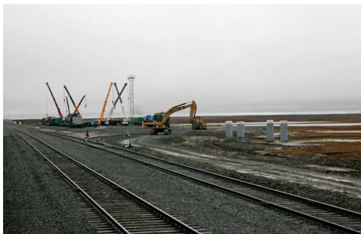
Ciężki sprzęt budowlany używany przy budowie linii kolejowej Obskaja – Bowanienkowo (24.09.2009 r.) Fot. Gazprom
