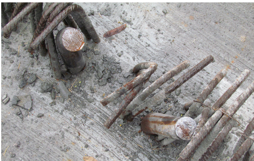
Rys. 1. Zniszczony uchwyt transportowy belki strunobetonowej T27
