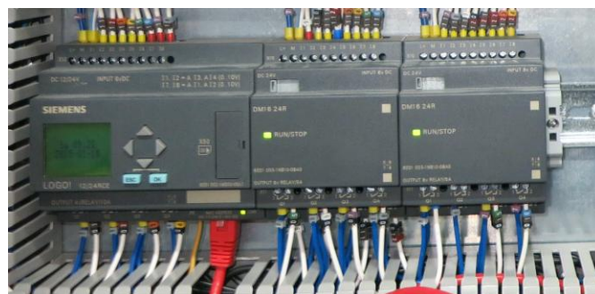
Rys. 3. Sterownik główny instalacji odwadniania i higienizacji osadu ściekowego zrealizowany na jednostce centralnej LOGO! 12/24RCE z dołączonymi dwoma modułami wejść/wyjść binarnych DM16 24R
