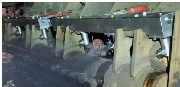
Fig. 3. Roll gap lubrication installation – oil nozzles Rys. 3. Instalacja smarowania kotliny walcowniczej – dysze olejowe
