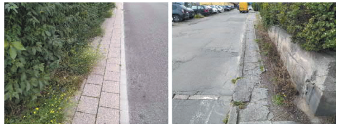
Fot. 10. Roślinność zabierająca przestrzeń chodnika oraz zły stan techniczny chodnika na ulicy Łębowskiej (fotografie – zasoby własne autorek)
