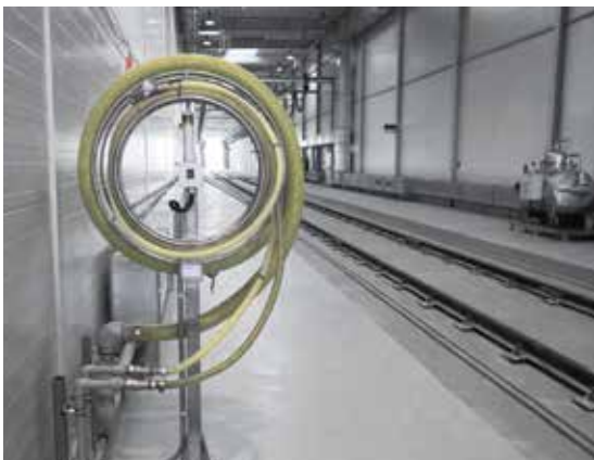
Wypożenie stanowiska do odfekalniania
