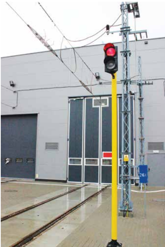
System odłączania i uszyniania sieci trakcyjnej z sygnalizacją. Fot. A. Massel
