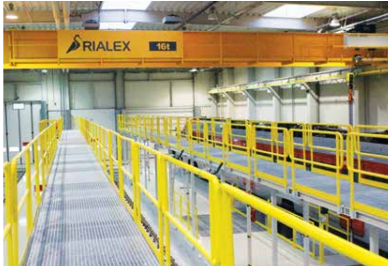
Pomosty wzdłuż kanałów ułatwiają dogodnie warunki do przeglądu do urządzeń montowanych na dachu zespołu. Fot. J. Raczyński
