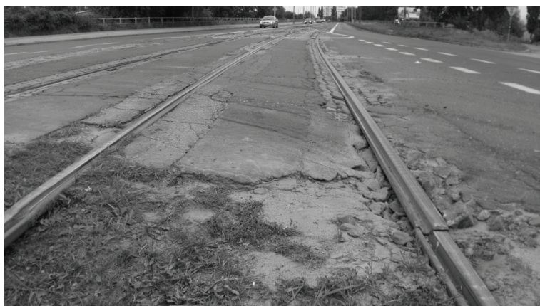
Fot. 7. Pęknięta szyna wraz z wycłapami na przejeździe nr 13 Siennicka – Stary Dwór
