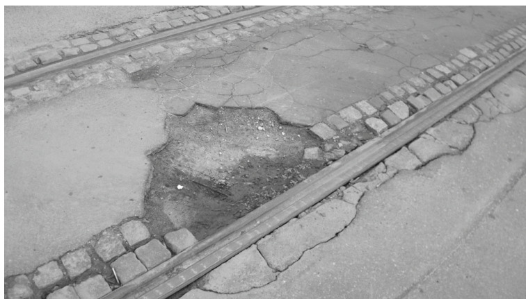
Fot. 4. Ubytki nawierzchni na przejeździe nr 167 Gdańska – Emilii Plater
