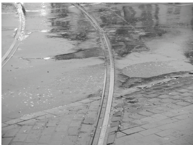
Fot. 1. Zastoisko wody opadowej na przejeździe nr 93 al. Grunwaldzka – Opata Jacka Rybińskiego
