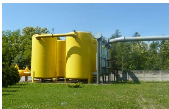
Rys. 10. Zbiorniki powierzchniowe gazu kopalnianego przy EC „Wesoła” Wydział IX [7]
