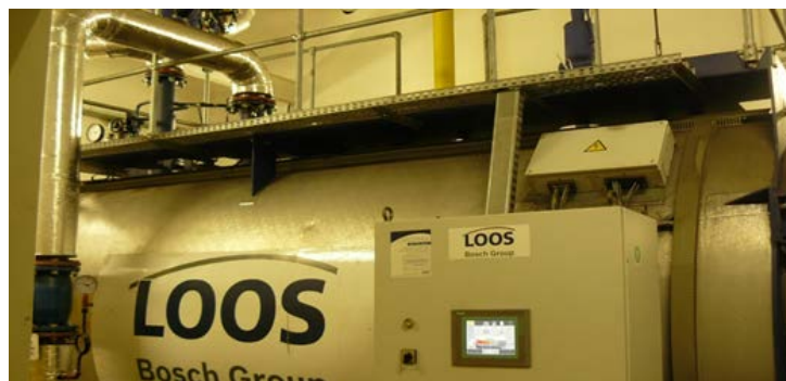
Rys. 3. Kocioł gazowy EC „Wieczorek” (Katowice) [7] Pic. 3. Gas boiler in „Wieczorek” plant (Katowice) [7]
