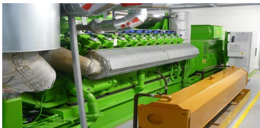
Rys. 5 Silniki gazowe EC „Wieczorek” (Katowice) [7].
