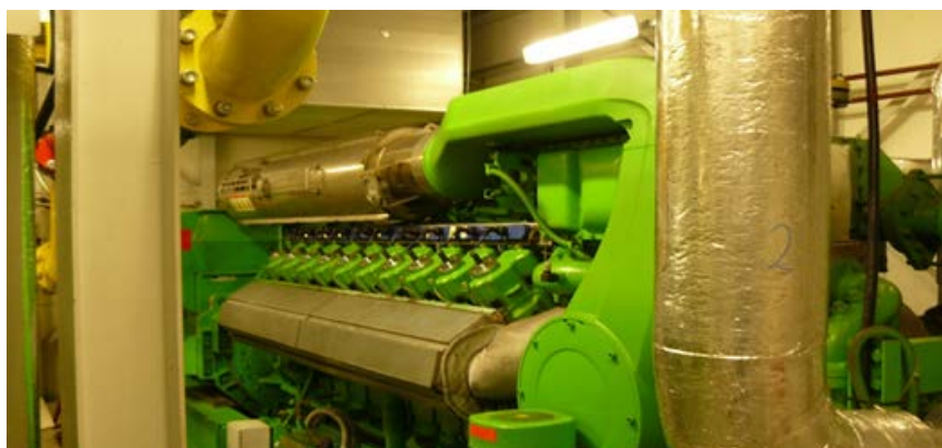
Rys. 5 Silniki gazowe EC „Wieczorek” (Katowice) [7].
