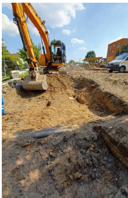
Rys. 7. Zdjęcie z miejsca uszkodzenia kabla SN
