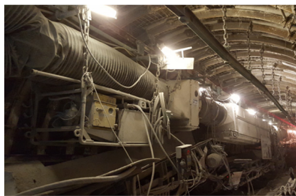
Rys. 12. Widok odpylacza suchego HBKO w LW „Bogdanka” S.A. [3] Fig. 12. View of the HBKO dry deduster at LW "Bogdanka" S.A. [3]
