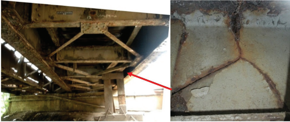
Rys. 3. Widok mostu oraz nieciągłości w podłużnicy
