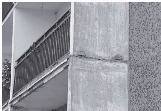
Rys. 3. Stan przedawaryjny logii budynku wysokiego (Poznań, M. Kanoniczak, 2018)
