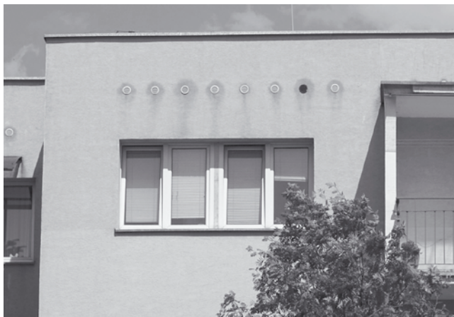
Rys. 4. Zawilgocenie przestrzeni stropodachu ujawniające się przy kratkach wentylacyjnych (Warszawa, P. Knyziak, 2016)
