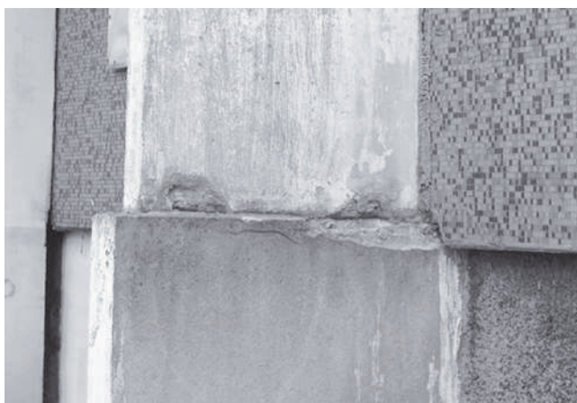
Rys. 5. Stan przedawaryjny logii budynku wysokiego (Poznań, M. Kanoniczak, 2018)
