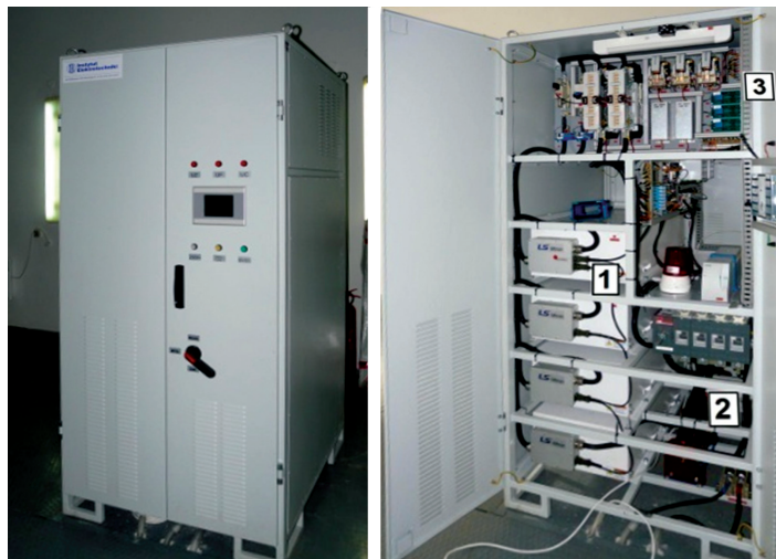
Rys. 2. Zasobnik superkondensatorowy zainstalowany w trolejbusowej podstacji trakcyjnej Północna w Gdyni
