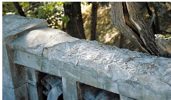
Fot. 10. Degradacja betonowych elementów balustrady
