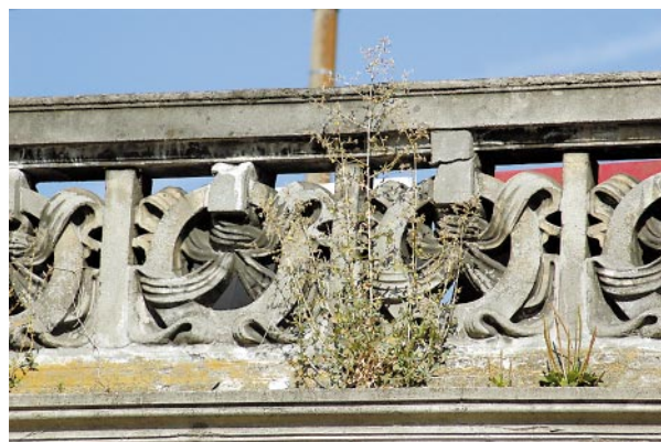
Fot. 11. Typowe uszkodzenia płyt ażurowych balustrady
