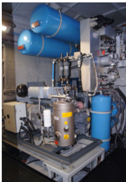
Rys. 8 Widok na sprężarkę i tablicę układu pneumatycznego
