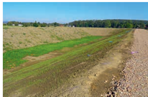
Wał eksperymentalny w Czernichowie – projekt i realizację automatycznego systemu pomiarowego z wykorzystaniem światłowodowego kabla sensorycznego do pomiaru filtracji wody wykonał Z.P.P.U.H. Budokop Sp. z o.o.
