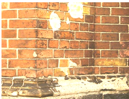
Ryc. 2. Skutek źle prowadzonych napraw muru i cokołu nawy. Źródło: fot. H. Rutyna, XII.2008
