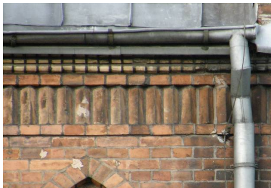
Ryc. 8. Nieszczelna obróbka blacharska rynien i rur spustowych. Źródło: fot. H. Rutyna, XII.2008 Fig. 8. Leaky gutter metal flashing and downpipes. Source: photo H. Rutyna, XII.2008
