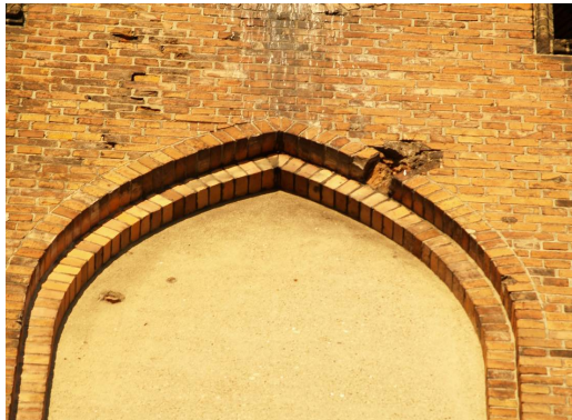
Ryc. 6. Fragment elewacji południowej. Stan zniszczenia licowej cegły: odpadające lico, spękania pod wpływem zbyt mocnej spoiny cementowej, drgań i zanieczyszczeń ze spalin komunikacyjnych. Źródło: fot. H. Rutyna, XII.2008
