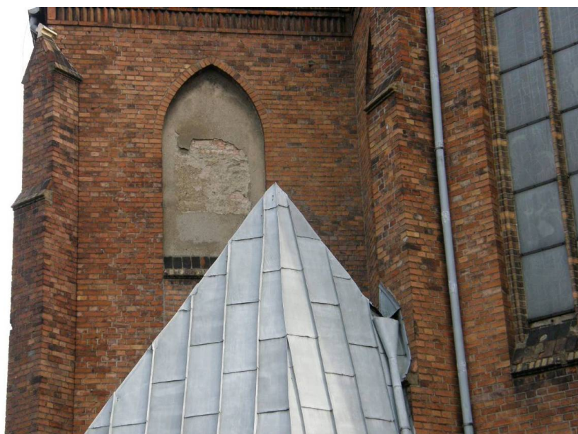
Ryc. 15. Ubytki tynku w blendzie w zachodnim szczycie prezbiterium. Źródło: fot. H. Rutyna, XII.2008
