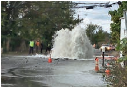
Ryc. 3. Wyciek wody ze zniszczonej magistrali wodociągowej w Nashville [5]
