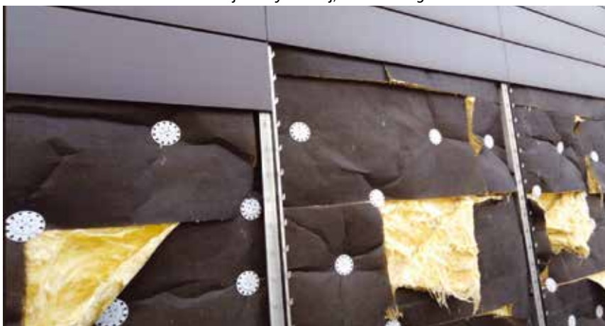
Fot. 2. Rozprężenie wełny mineralnej prowadzące do zaniku przestrzeni wentylowanej; źródło: fotografia autorów
