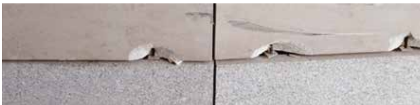
Fot. 3. Uszkodzenie połączenia „ruszt – elewacja”; źródło: fotografia autorów
