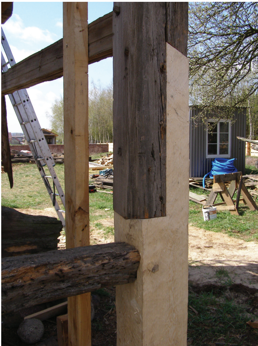
Il. 2. Wiatrak koźlak w Chrośnie w trakcie prac remontowych; widoczne złącze naprawcze słupa narożnego północno-zachodniego; fot. F. Tomaszewski, kwiecień 2021 r.
