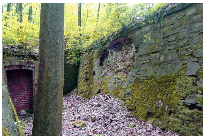
Ryc. 9. Ubytki w murze, którego lico wykonano konstrukcji muru i obramień oraz naroży
