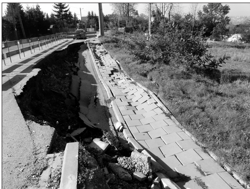
Fig. 5. Nisza osuwiskowa przy ul. Sawiczewskich w Krakowie-Swoszowicach. Fot. R. Kaczmarczyk
