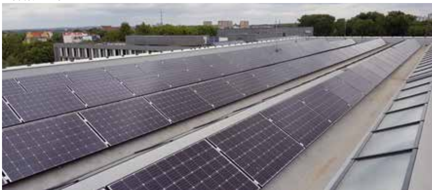
Fot. 8. Ogniwa fotowoltaiczne nad dziedzińcem; źródło: APPSRA
