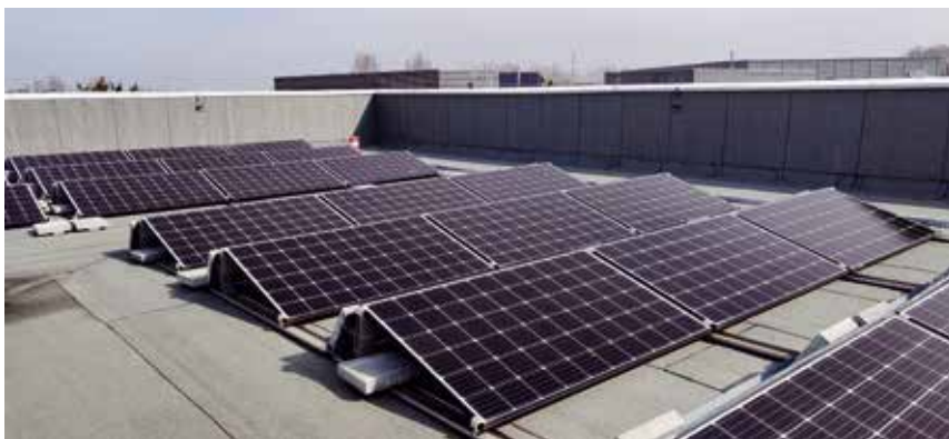
Fot. 9. Ogniwa fotowoltaiczne na dachu budynku; źródło: APPSRA
