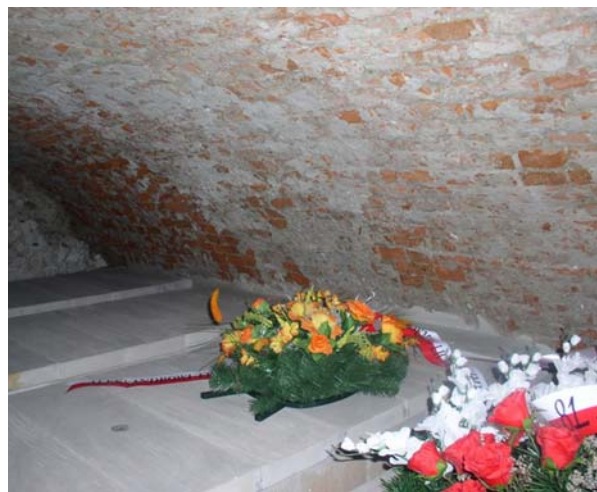
Fot. 5. Podziemia kościoła w Rudkach w trakcie procesu osuszania – 2006 r.
