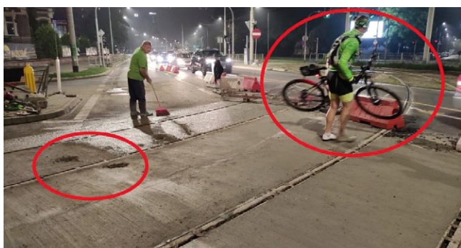
Rys. 2. Wejście pieszego na teren budowy na skrzyżowaniu ul. Legnickiej i ul. Bolesławieckiej (DOLMED) oraz spowodowane uszkodzenia nawierzchni
