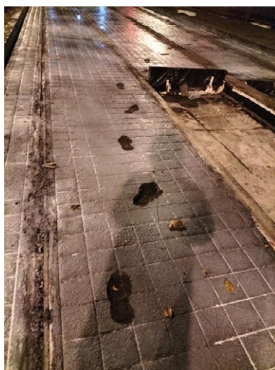
Rys. 8. Uszkodzenie nawierzchni na ul. Wyszyńskiego
