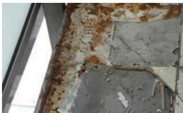
Fot. 6. Korozja chemiczna obróbki blacharskiej balkonu
