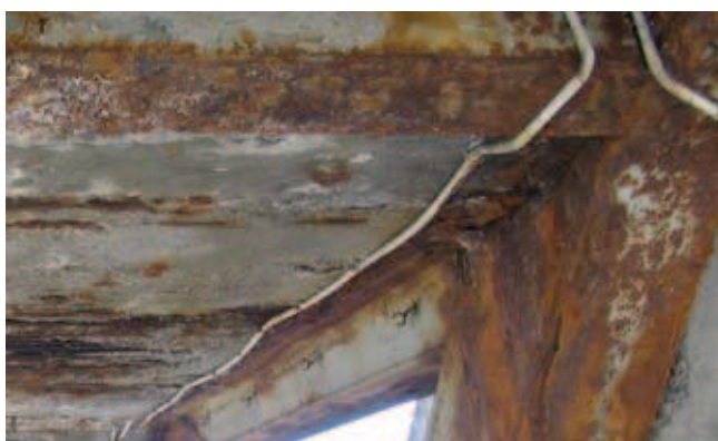
Fot. 5. Korozja wżerowa stalowej konstrukcji kładki dla pieszych
