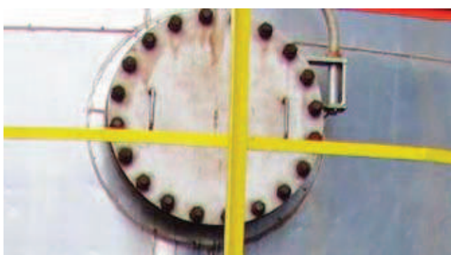
Fot. 3. Korozja śrub stalowych w środowisku przemysłowym z okresowym działaniem bryzy morskiej
