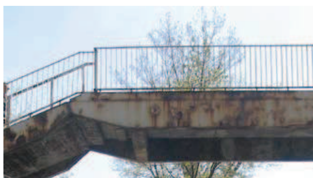
Fot. 4. Korozja wżerowa stalowej konstrukcji kładki dla pieszych
