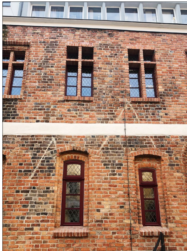
Ryc. 6. Ratusz w Koźuchowie, elewacja północna, portal oraz ślady po dachach kramów, rok 2017; fot. A. Legendziewicz.
