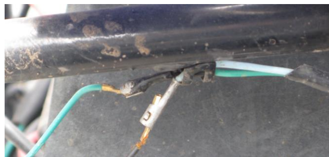
Rys. 3. Przykład nieprawidłowego montażu instalacji elektrycznej
