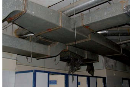
Uszczelki w kanałach wentylacyjnych budynku użyteczności publicznej.
