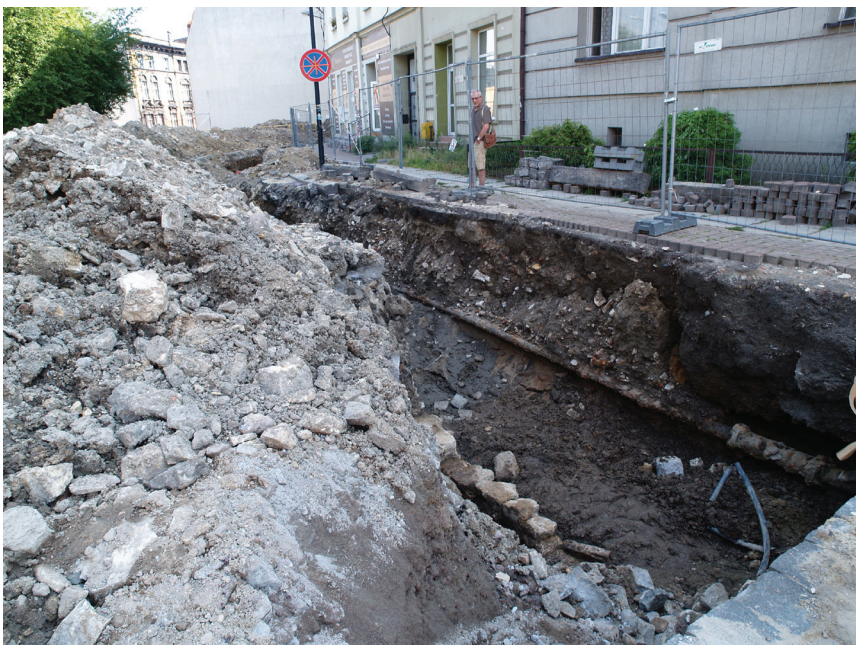
Fot. 3. Zniszczona część południowa muru z widoczną rurą instalacyjną
