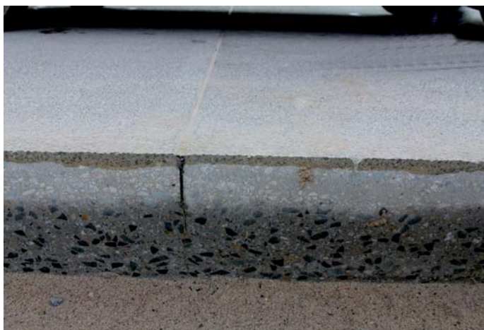
Fot. 1. Szczelina wypełniona zalewą
