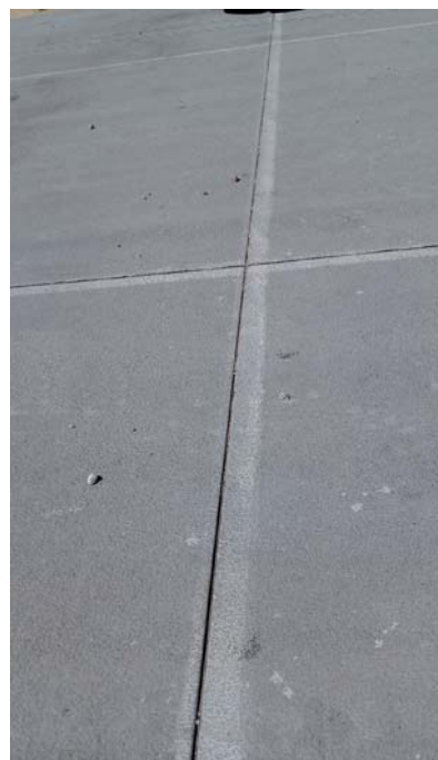
Fot. 2. Szczeliny poprzeczne i podłużne w nawierzchni betonowej
