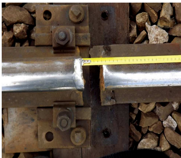
Rys. 12. Złamanie szyny na spinie termitowej
