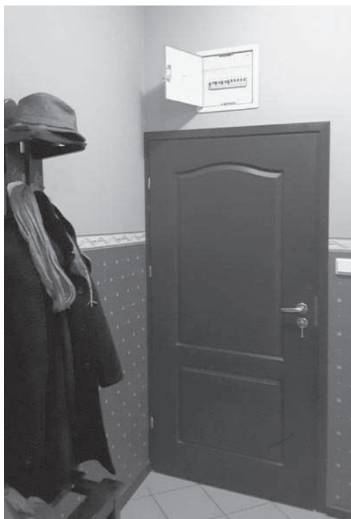
Fot. 1. Niedostępna – bariera techniczna w instalacji elektrycznej w mieszkaniu (fot.autora)
