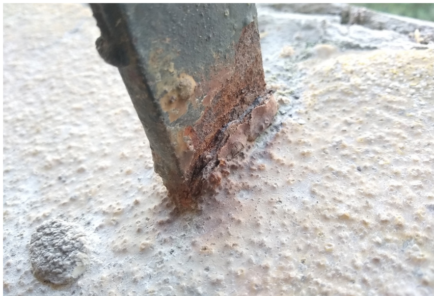
Rys. 2. Korozja słupka balustrady w miejscu połączenia z płytą balkonową
