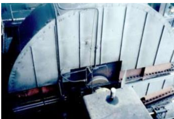
Rys. 1 Wentylator do transportu pyłu węglowego w instalacji spalania węgla
