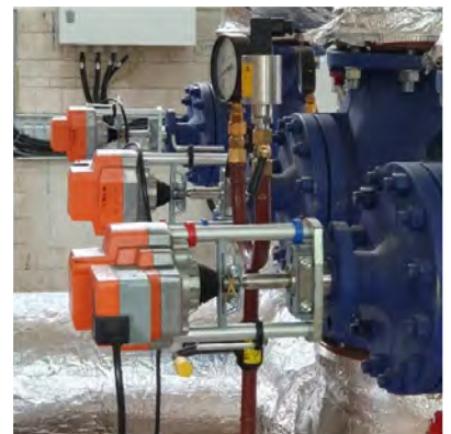
Rys. 6. Zawory regulujące przepływ turbin
