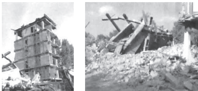
Rys. 5. Katastrofa podczas rozbiórki budynku o konstrukcji stalowej na terenie dawnej huty Baildon (Katowice 2009); fot. z archiwum PIP [30]
